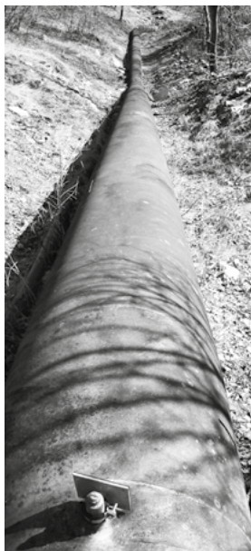
Conduite forcée LYSA
