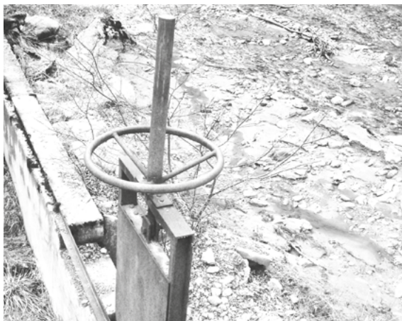
Prise d'eau du bisse de l'Ernaya
