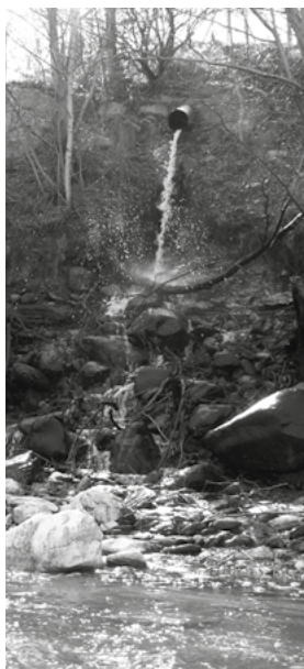
Rejet des eaux traitées
